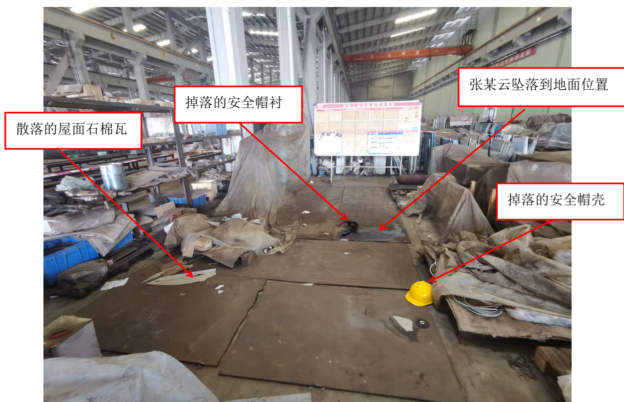
图一 事故现场情况
