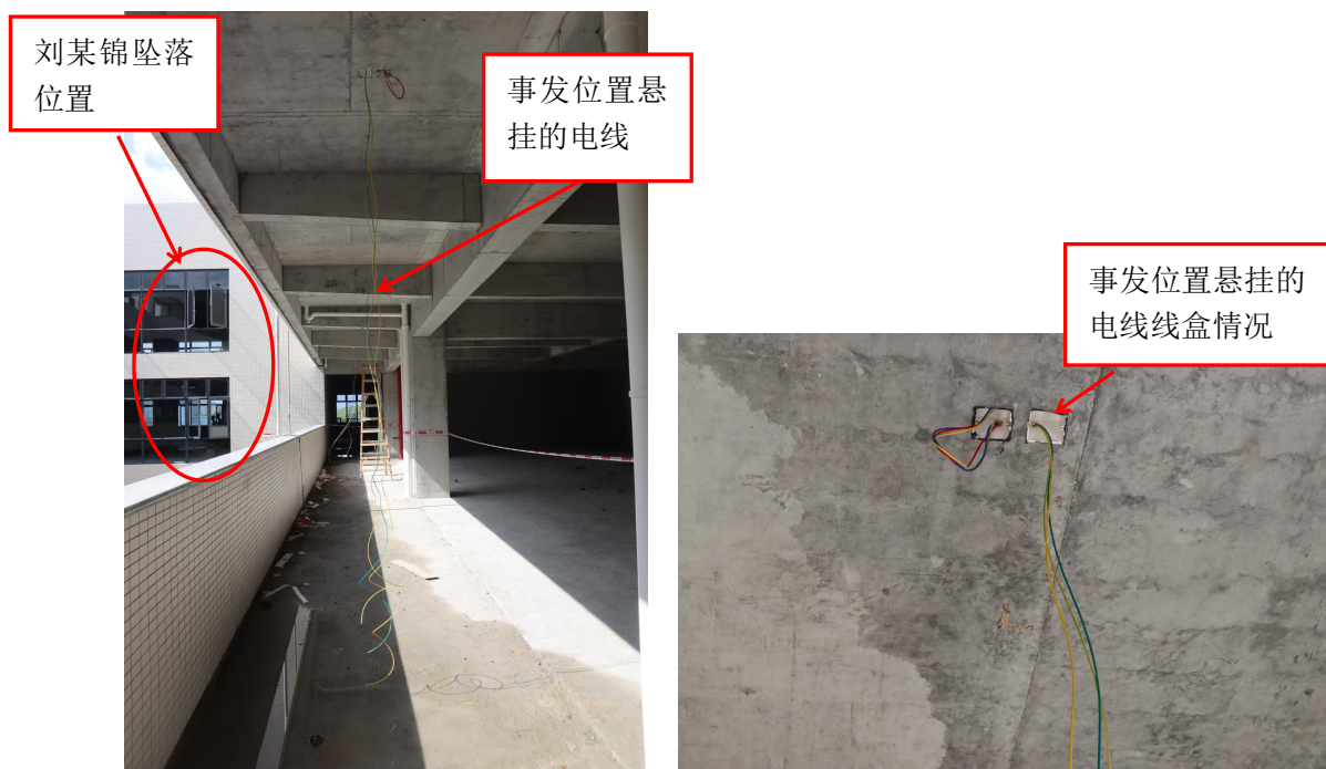
图 2 事故现场情况
