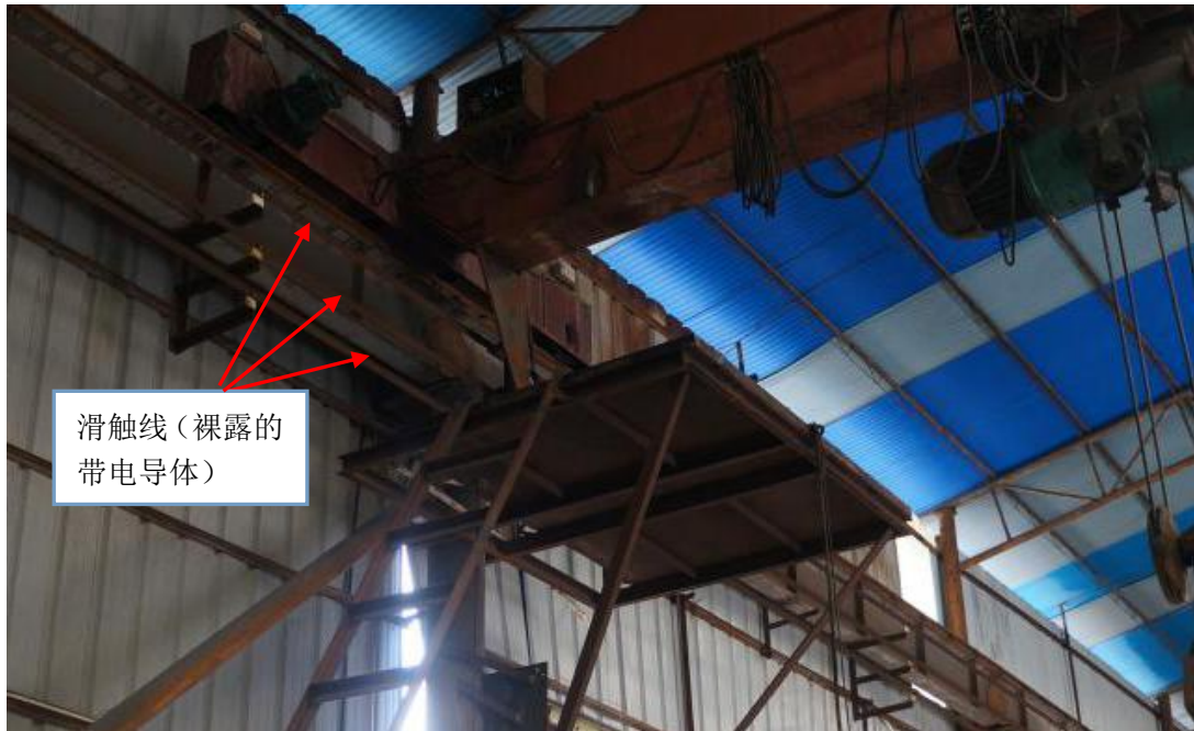
图 2 事故现场照片
