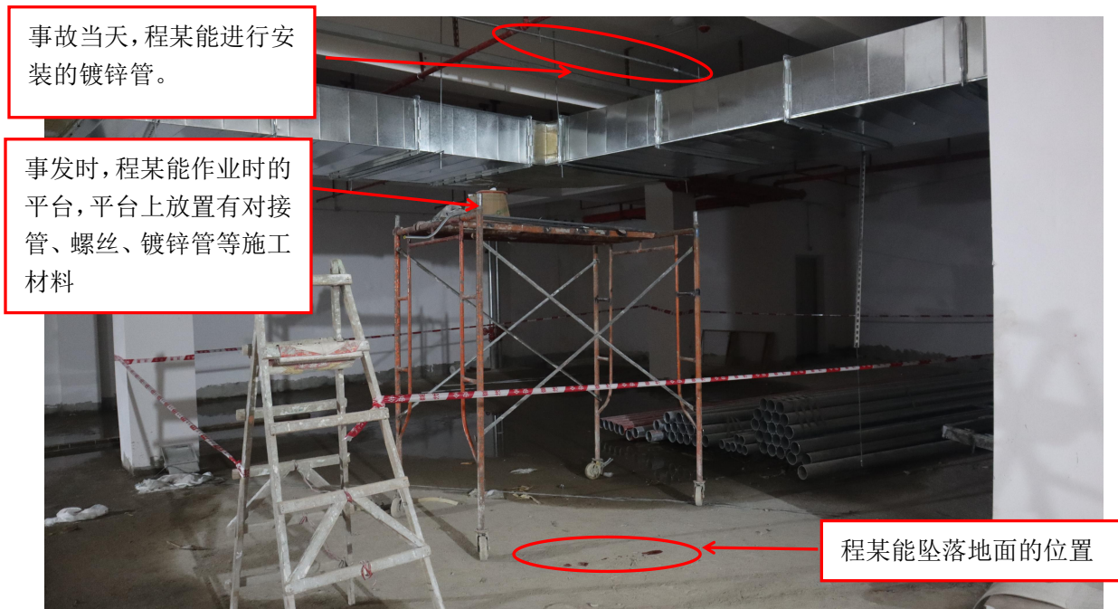
图 1 事故现场情况
