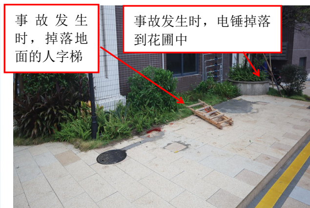
图二 事故现场情况
