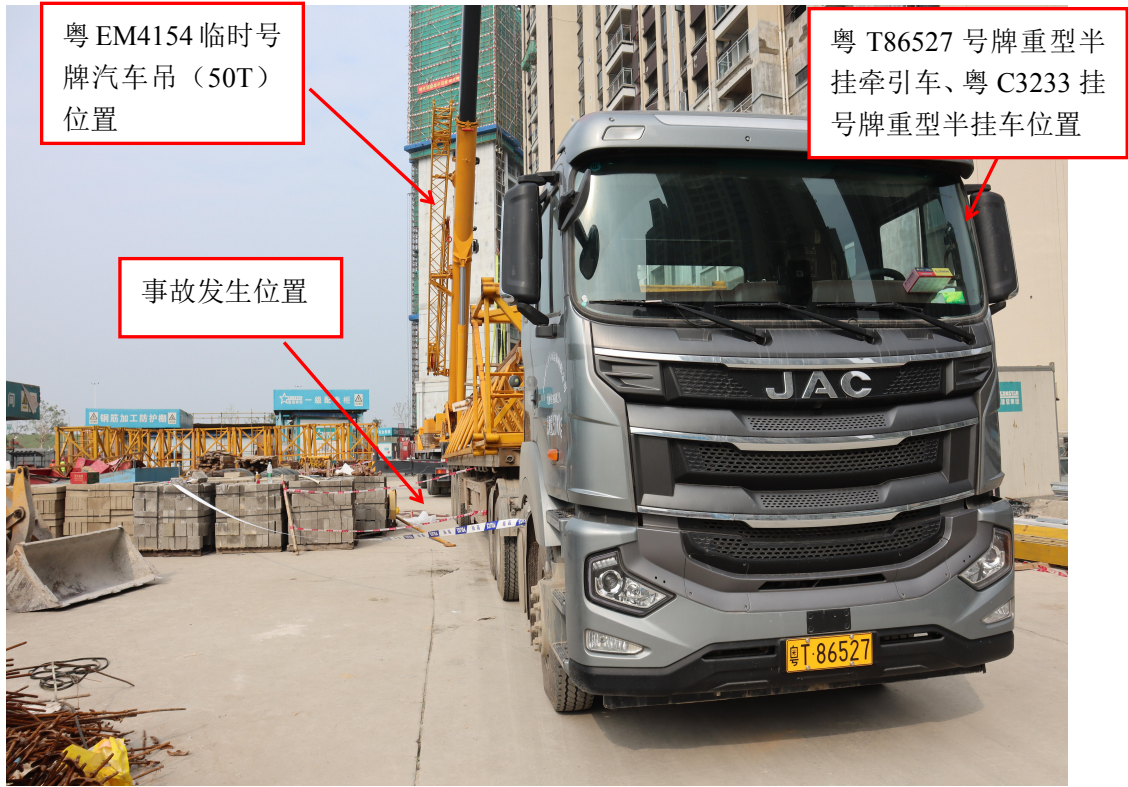
图一 事故现场情况
