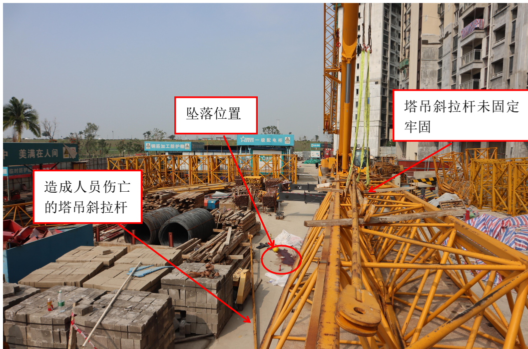
图二 事故现场情况
