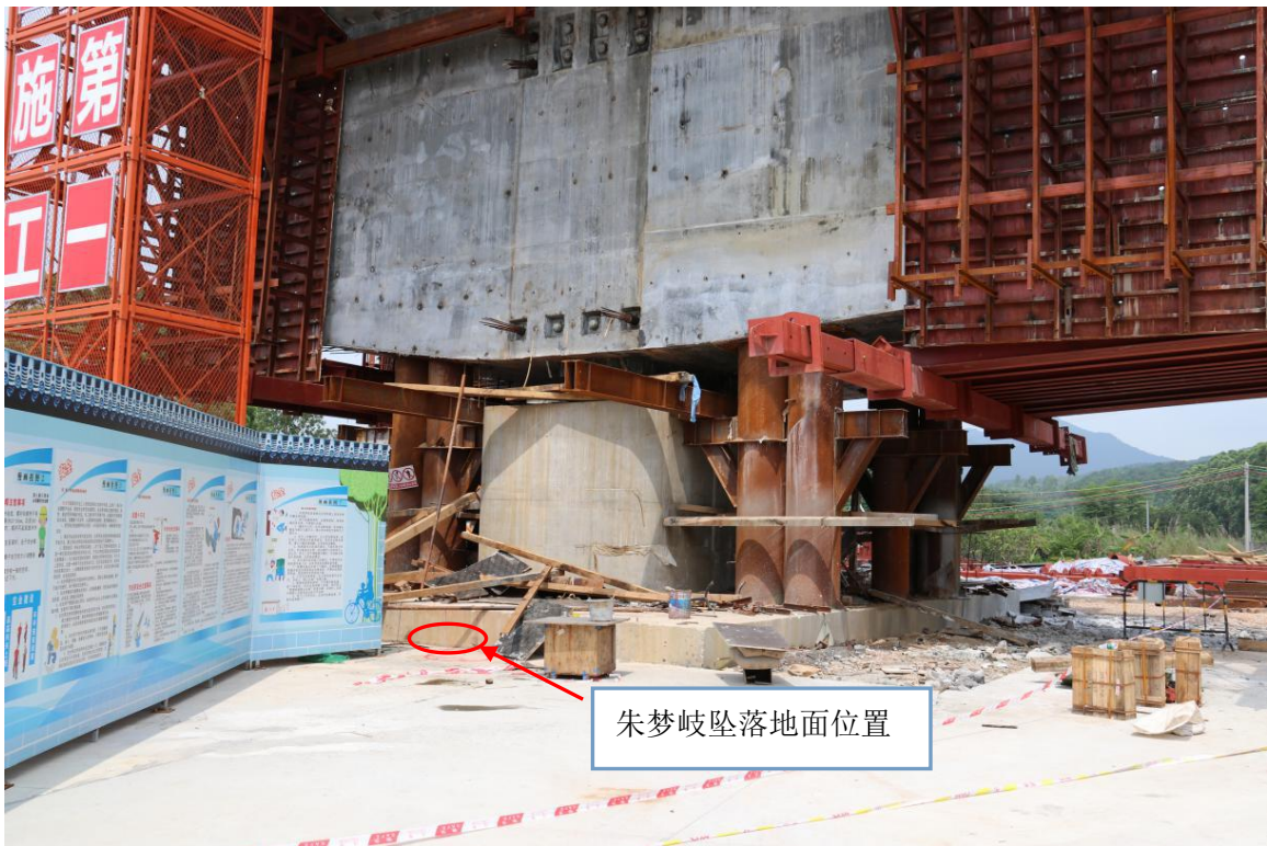
图二 事故现场情况
