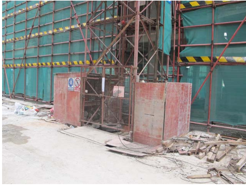
图一 提升机首层情况
